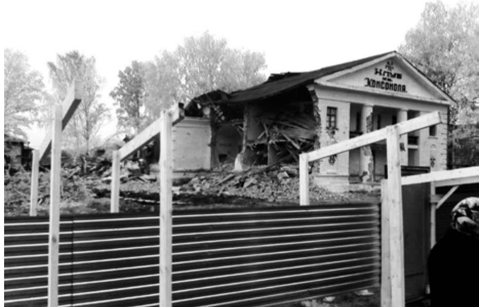
На фото: Клуб им. Комсомола в день его разрушения, со снесенной одной из стен
